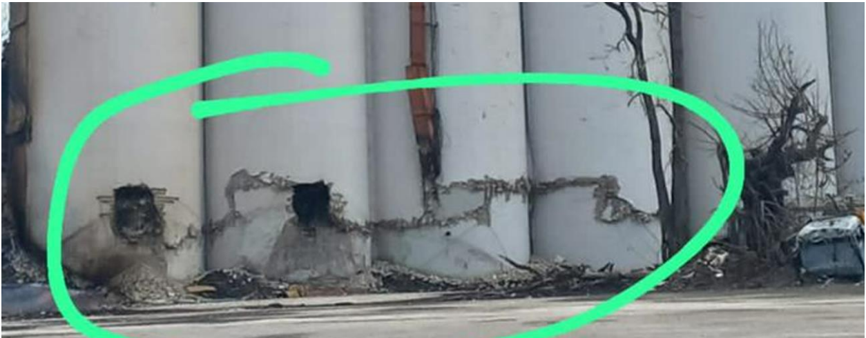
Figure 16. اتصال التشققات المنطلقة من الثقوب الكبيرة للصوامع الاربعة المتبقية من المجموعة الشمالية
